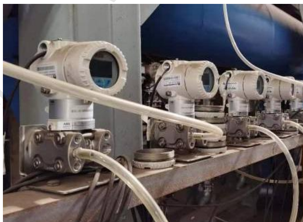
图 7 微差压变送器设置安装情况
